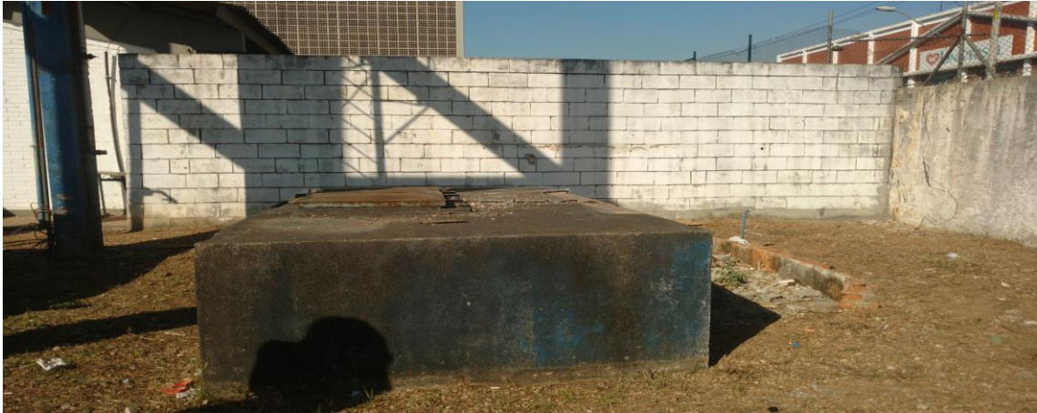
Imagem da cisterna de 20 mil litros que atualmente encontra se desativada
